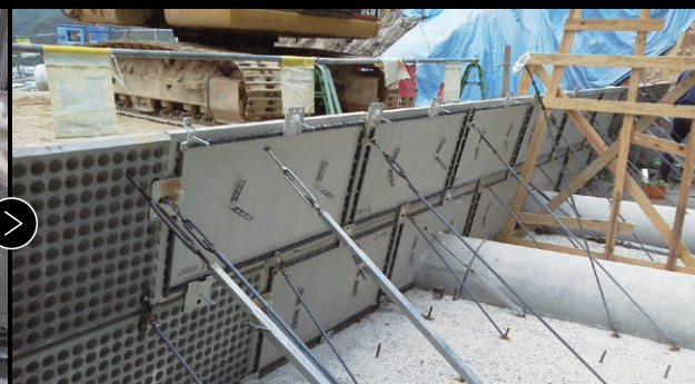
02: 専用勾配調整サポート使用状況
