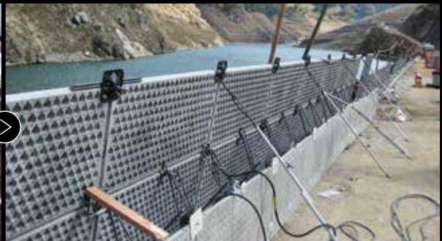
02: 専用勾配調整サポート使用状況
